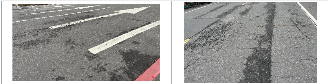
圖 2 道路鋪面受損情形
